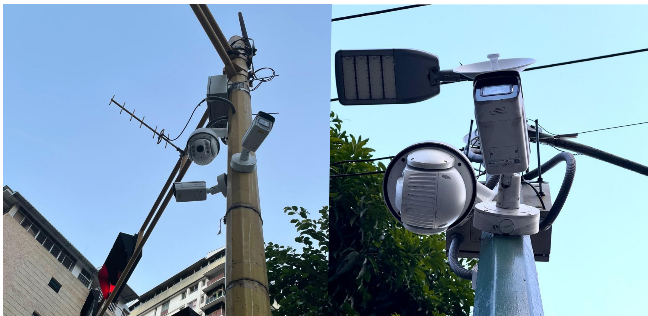
Cámaras fijas y PTZ Hikvision en el sector Altamira (izquierda) y Los Palos Grandes (derecha) del municipio Chacao. (Source: VEsinFiltro)
